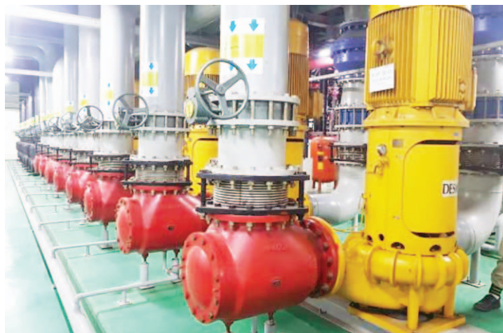
Hệ thống chiller giải nhiệt nước tại tòa nhà Lotte
