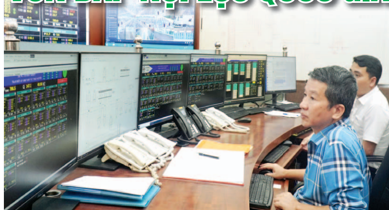
Trung tâm điều khiển xa (Công ty Điện lực Thái Nguyên)
