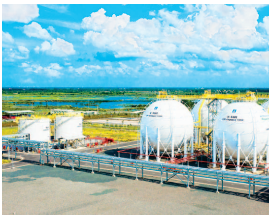
Nhà máy GPP Cà Mau
