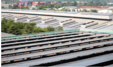
Hệ thống điện mặt trời mái nhà tại Công ty CP Cao su Đà Nẵng
