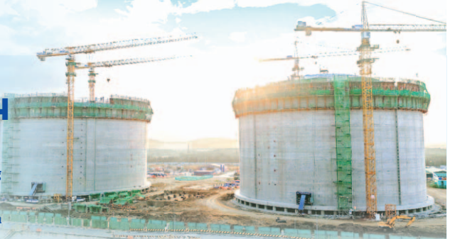
Những bể Ethane siêu lạnh chuyên dùng đầu tiên tại Việt Nam được xây dựng bởi sự hợp tác giữa trí tuệ quốc tế và năng lực thi công vượt trội của nhà thầu nội địa PTSC
