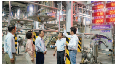
Doanh nghiệp Đà Nẵng được hỗ trợ cải tiến lò hơi để sản xuất sạch hơn thông qua chương trình khuyến công
