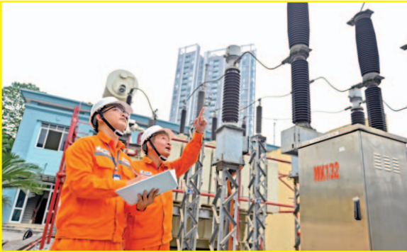
Công nhân điện lực kiểm tra thiết bị tại trạm biến áp giữa thời điểm nhu cầu sử dụng điện tăng cao
