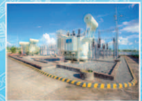
Cung cấp, lắp đặt trọn bộ trạm biến áp
