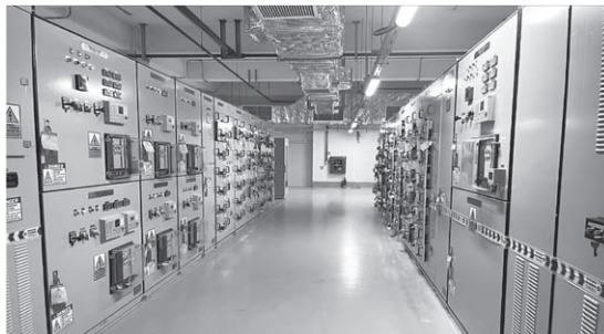
Hệ thống tủ điện động lực được lắp đặt tại Nhà máy Nhiệt điện Vũng Áng 2
