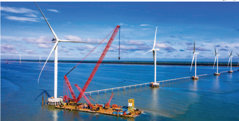
Nhà máy điện gió Đông Hải
