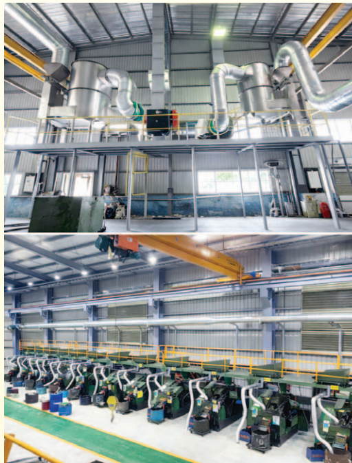
Hệ thống thu gom và xử lý khí thải được lắp đặt trong nhà xưởng cơ khí
