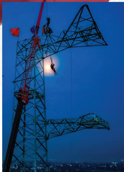
"Nhịp điệu trắng râm" trên đường dây 500kV
