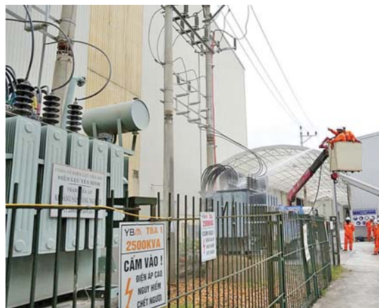
Công nhân kiểm tra Trạm biến áp 110kV phục vụ khu công nghiệp phía nam Lào Cai
