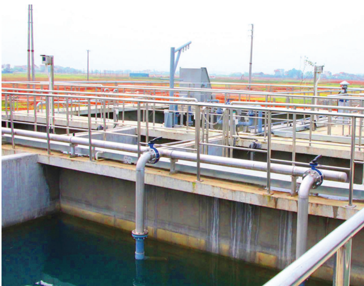
Hệ thống xử lý nước thải tại CCN Thanh Vân
