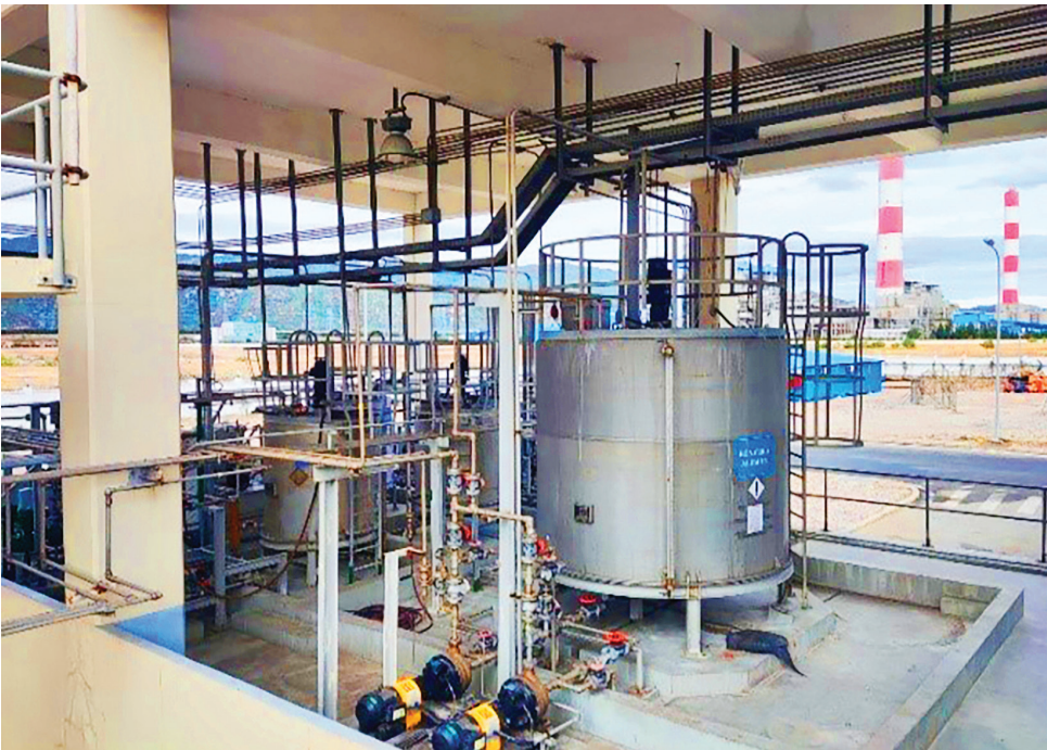
Hệ thống xử lý nước thải tập trung tại Nhà máy Nhiệt điện Vĩnh Tân 4
