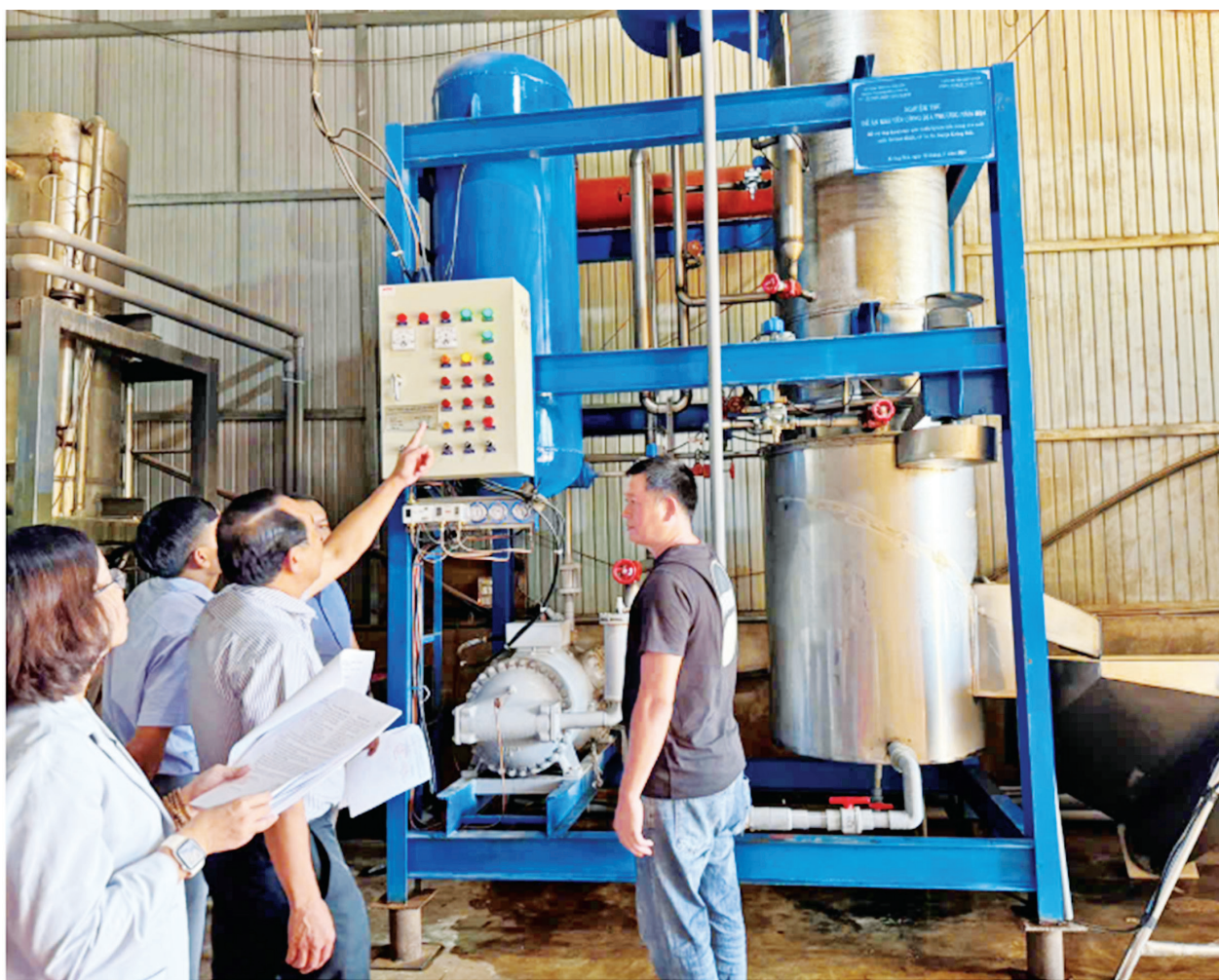
Thiết bị được hỗ trợ từ nguồn khuyến công địa phương năm 2024 tại Công ty TNHH Thương mại EPIS (xã Cư Prao, tỉnh Đắk Lắk)
